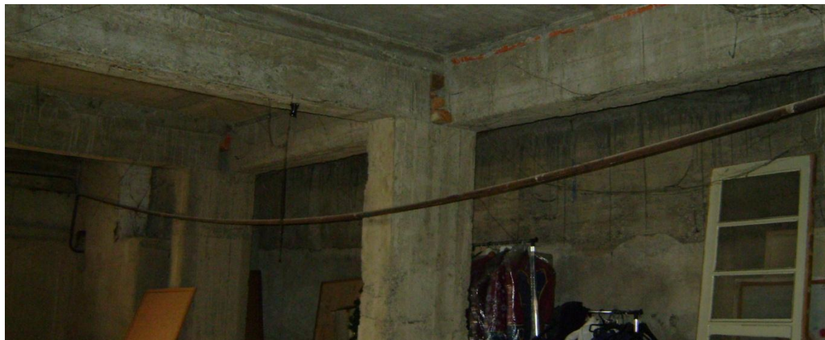
Obješena i toplinski neizolirana cijev u negrijanom prostoru
